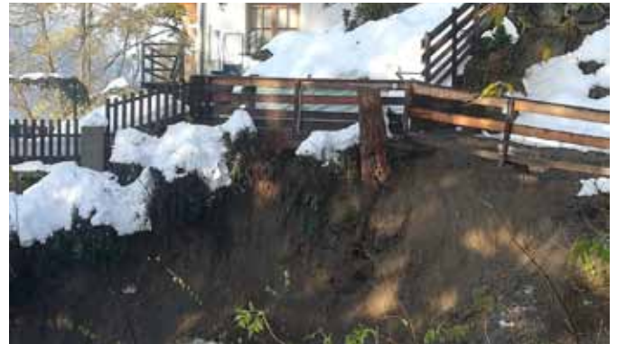
Böschungsabbruch in Untergaimberg
