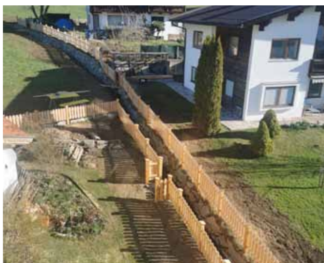
Beim Wildbachprojekt „Großbach/Langennitzbach“ wurden die betroffenen Gärten wieder hergestellt und der Bereich im Ortskern mit einem Holzzaun versehen.
