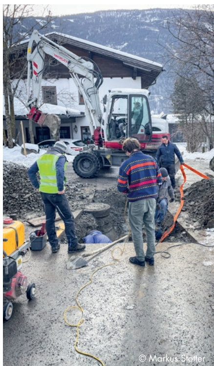
▲ Dank der vielen freiwilligen Helfer konnte das Leck schnell gefunden und die Leitung wieder instandgesetzt werden.
