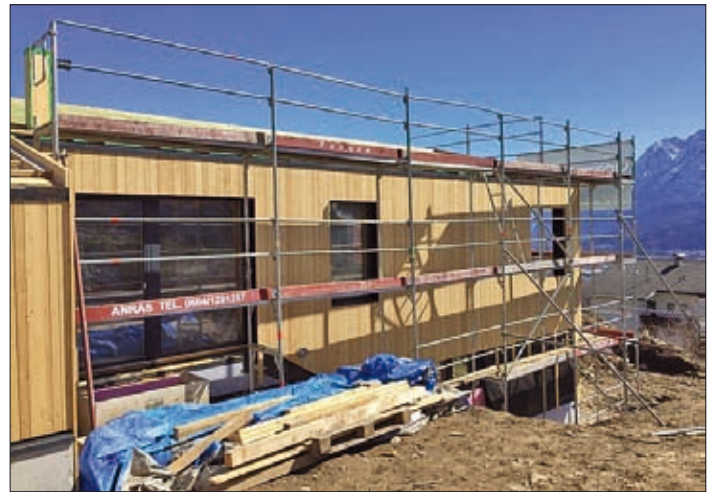
Ute und Thomas Igel errichten im Weberlefeld ein Einfamilienwohnhaus mit Carport (Baubeginn Oktober 2018).
