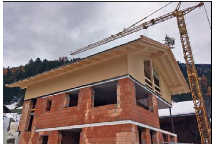
Bei der Hofstelle Peterer im Oberdorf errichtet Frau Veronika Tschapeller ein neues Wohnhaus (Baubeginn September 2019).
